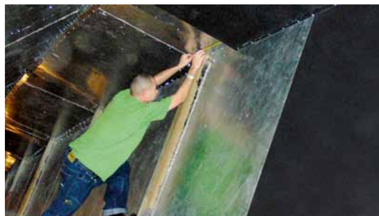
Las enormes tuberías de aire fueron aisladas con AP Armaflex, con lo que se consiguió un fiable control de la condensación
